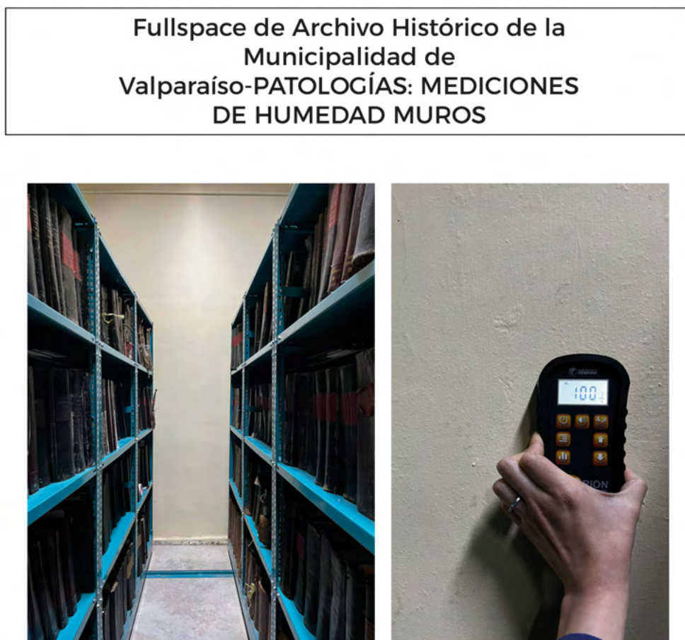
Figura 95 Fotografías de las patologías del muro del Fullspace del Archivo Histórico de la Municipalidad de Valparaíso
