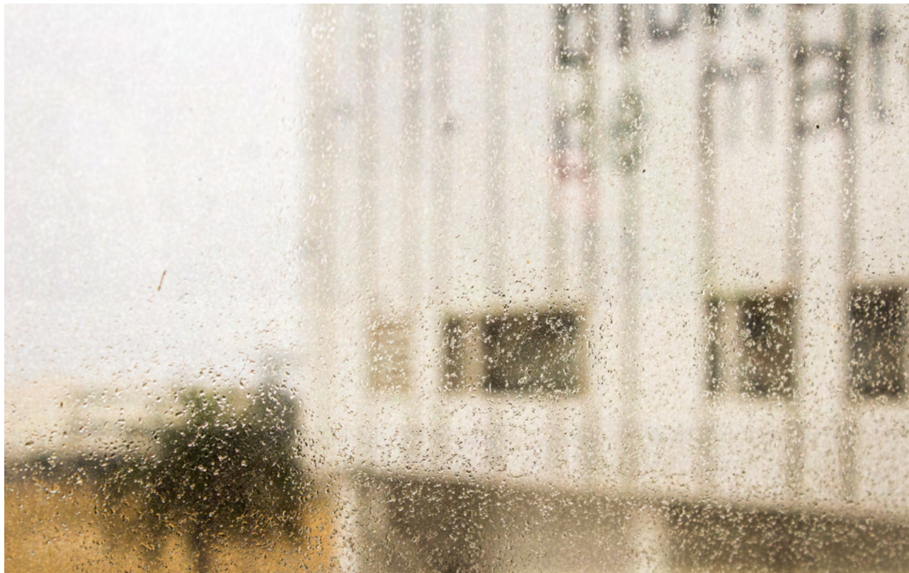
Figura 52 Fotografía que ejemplifica el fenómeno de condensación en la ventana del Archivo MW, donde se pueden ver las gotas de agua y humedad producto del exterior frío e interior más cálido
