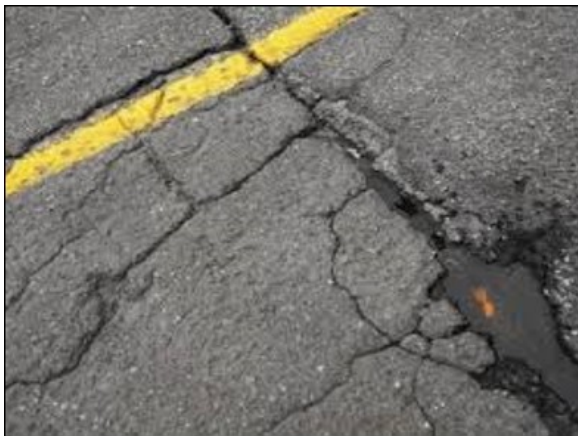
Figura 6: Daño por Humedad en Mezcla Asfáltica.
