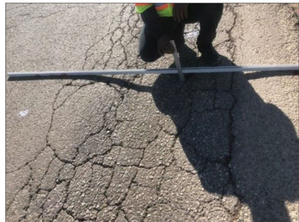
Figura 7: Daño por Ahuellamiento en Mezcla Asfáltica.
