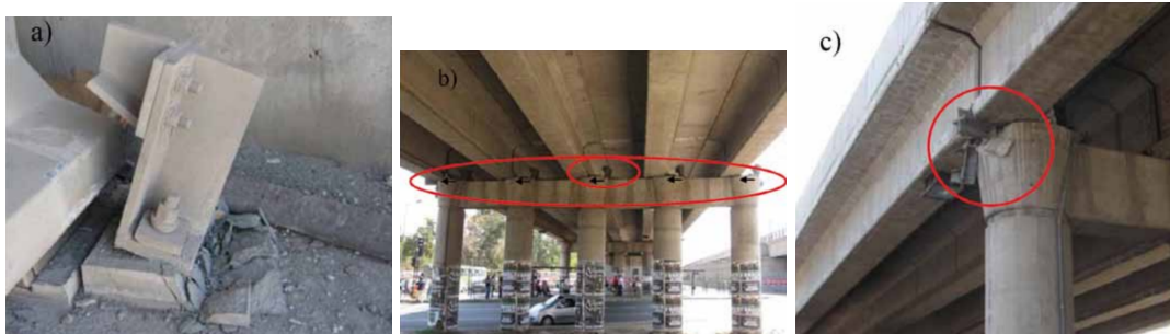
Figura 1.2: Daños observados en Autopista Vespucio Norte [2]
