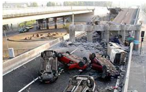
Figura 3: Colapso del Paso Superior Lo Echevers
