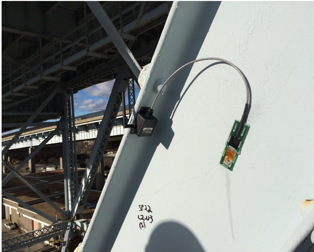
Figura D.1.8: Strain gauge inalámbrico instalado sobre una viga de acero (Resensys)
