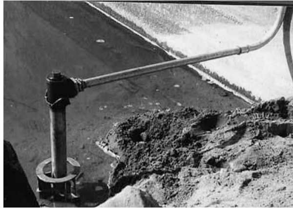
Figura D.2.5: Instalación de un magnetic sliding collar (Hunt, 2009)
