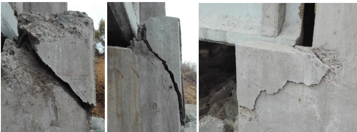
Figura 137 Daños en topes evidenciados en Puente Petorca, en 2015 Terremoto Los Vilos 2015. Elaboración Propia.
