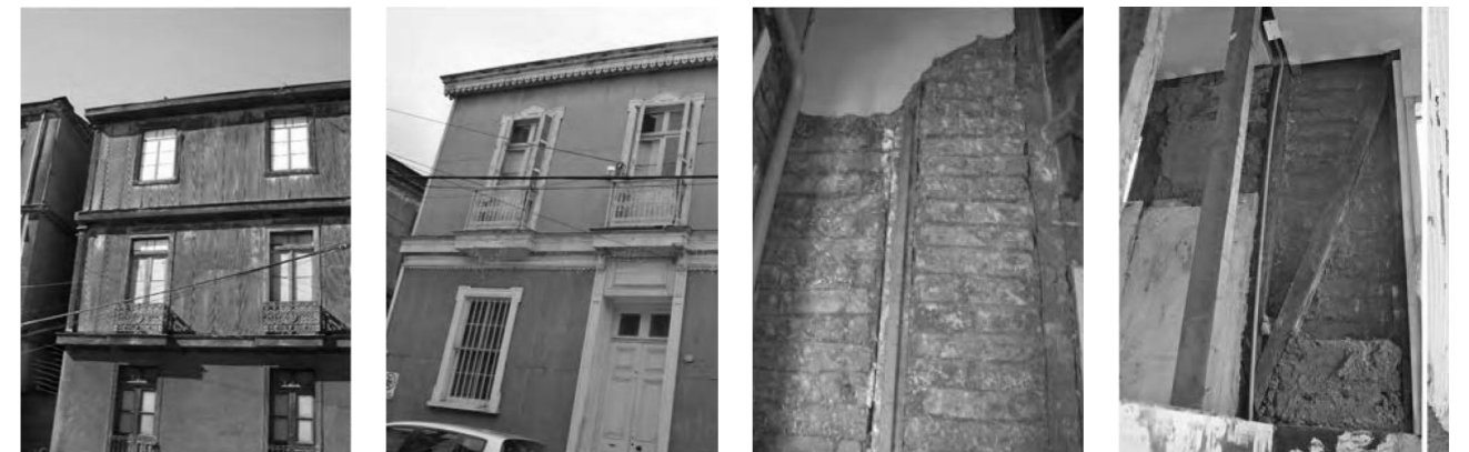
Figura 49 Fotografías de tipologías residenciales, tecnología de tabiques de madera con adobillos, Valparaíso. Fuente: Jorquera, 2014, p. 35.
