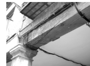
Figura 133 Sup. fendas en zig-zag de una cubierta, inf. fenda en una viga. Fuente: Lasheras, 2009, p. 799. López et al., 2004, p.134.
