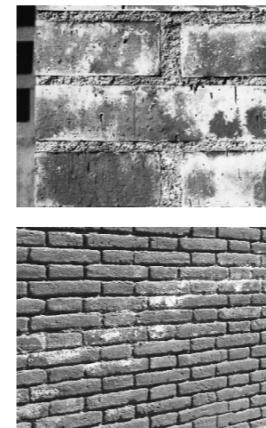
Figura 118 Manchas de eflorescencias en un muro de una obra de fábrica. Fuente: Broto, 2006, p.121.
