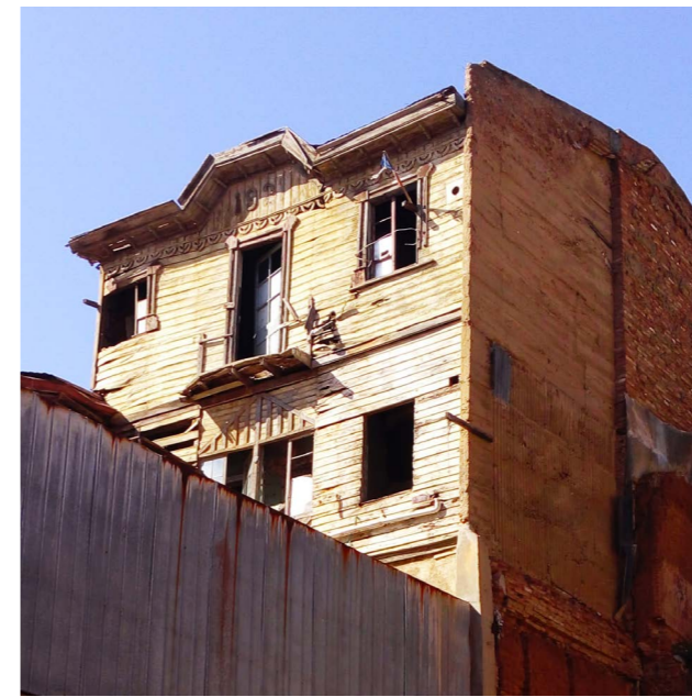
Figura 6 Fotografías de inmuebles deteriorados en la izquierda, cerro Cordillera y derecha, cerro Alegre. Fuente: Archivo propio, 2022.
