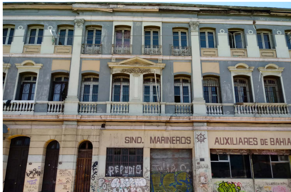
Figura 4 Fotografía de la fachada de un inmueble de la calle Blanco deteriorado. Fuente: Archivo propio, 2022.
