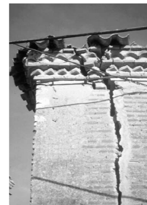
Figura 124 Fotografía de un alabeo en un muro de fábrica. Fuente: Monjo, 1999, p.111.
