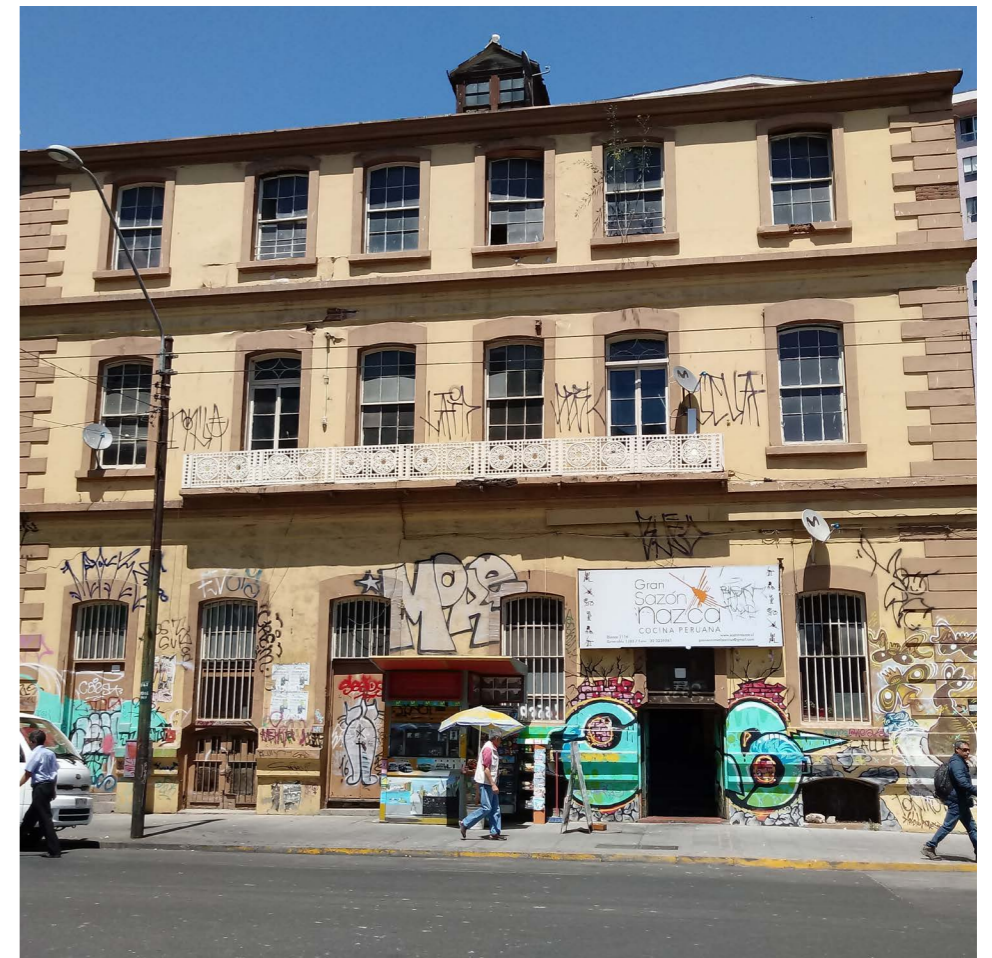
Figura 1 Fotografía de inmueble de albañilería de ladrillo en Valparaíso. Fuente: Archivo propio, 2022.
