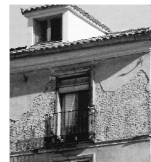
Figura 127 Fotografía de erosión mecánica producida por partículas transportadas por el viento sobre el mortero de agarre en un muro de ladrillos. Fuente: Broto, 2006, p. 111.
