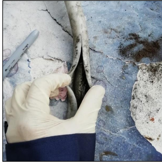
Figura 7.4 Acumulación de sólidos línea de alimentación
