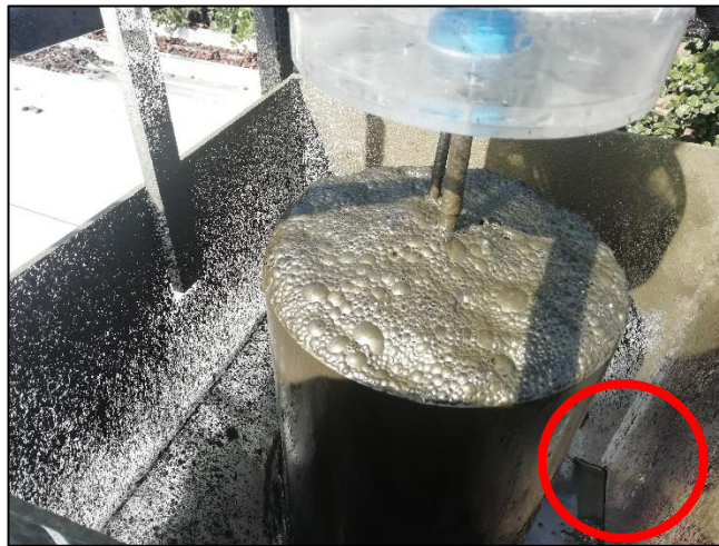
Figura 7.1 Vista tope columna acumulación de sólidos zona de rebalse
