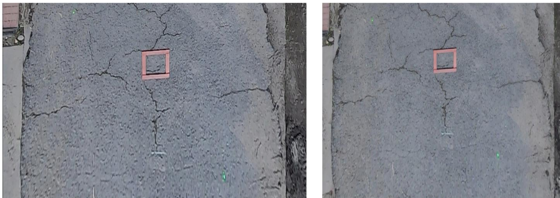
Figura 4.3. Fotos de la misma zona de pavimento agrietado. La imagen de la izquierda fue obtenida con grabación en 1920 pixeles, y la de la derecha en 4K.
