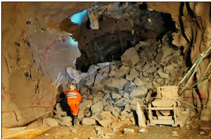
Figura 1: “Daños producidos por estallidos de roca en la mina El Teniente, Chile (Fuente: Rojas, 2017)”
