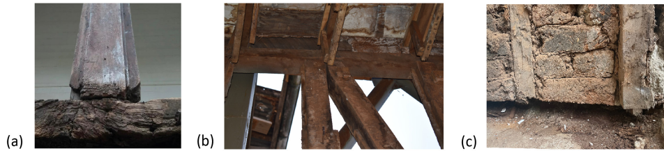
Fig. 93 Fotografías casos de humedad: (a) Caso 5: Calle Ossandón #275, encuentro entre solera y pie derecho afectado por humedad y termitas; (b) Caso 1. Calle Higueras #179, cielo afectado por humedad; (c) Caso 1: Calle Higueras #179, solera desvanecida por humedad y termitas.
