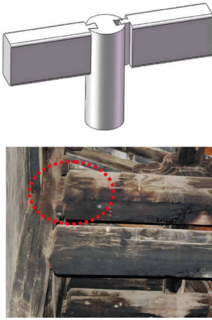
Fig. 26 Construcción de una unión caja y espiga con daños post terremoto, espiga arrancada de la caja. (Zhou & Yan, 2015).
