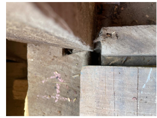
Fig. 94 Fotografía ensamble cola de milano traccionada encontrado en el Caso 5: Calle Ossandón #275.
