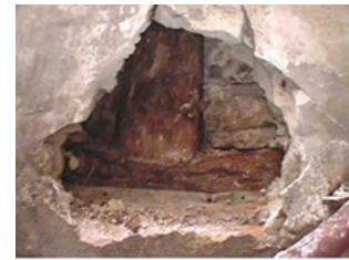
Fig. 31 Fotografía aplastamiento de solera inferior. (Lasheras, 2009).
