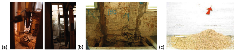
Fig. 33 Fotografías de daños por agentes biológicos: (a) Unión entre pilar y viga eliminada por termitas (Jimeno, 2015); (b) Acumulación de fecas de isóptero expulsada de las galerías. (Ripa et al., 2004).
