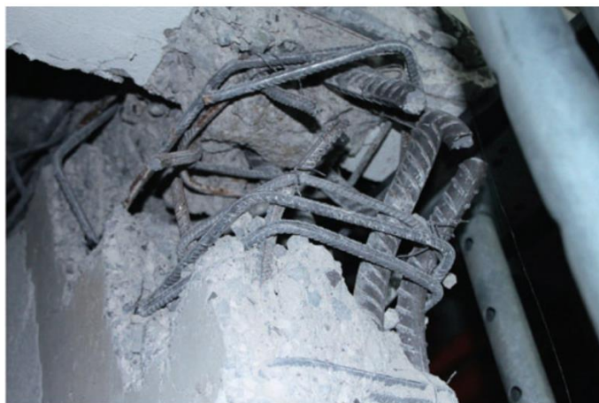
Fig. 9. Daño asociado a fatiga de bajo ciclaje en edificio de Chile después del terremoto del Maule 2010, Fuente: Naeim et al. [4].
