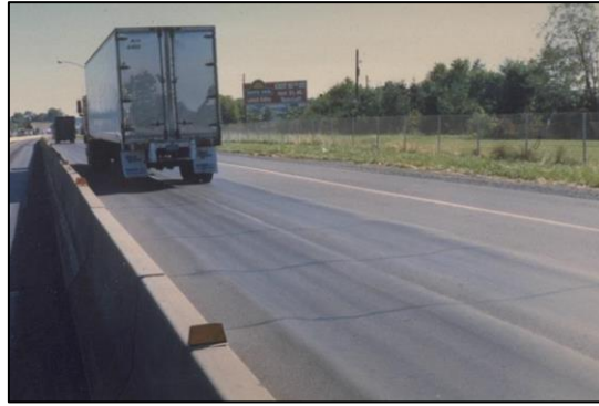
Figura 1.6.1. Ahuellamiento de pavimentos asfálticos. (A. Osorio, 2020)
