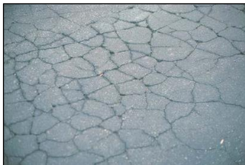
Figura 1.6.2. Agrietamiento por fatiga de pavimentos asfálticos. (FHWA, 2014)
