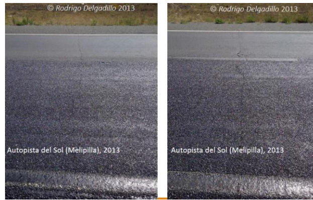
Figura 1.6.3. Agrietamiento térmico de pavimentos asfálticos. (Delgadillo,2022)
