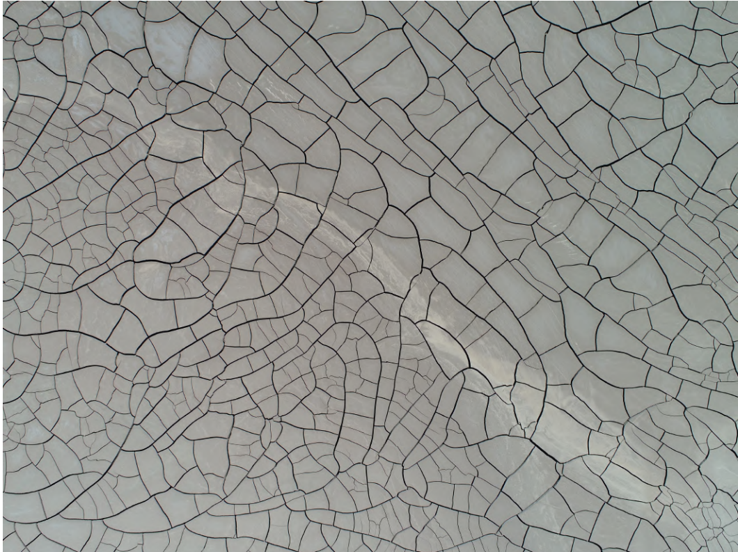
Figura 3.12: Agrietamiento Superficial en un Depósito de Relaves del Norte de Chile, del cual se Extrajo las Muestras MR1.
