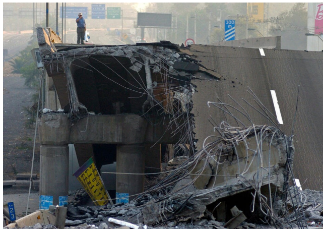
Figura 1.1: Puente colapsado en Santiago tras el terremoto del 27 de febrero de 2010 [4].
