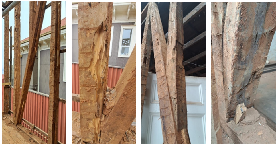
Figura 118 Secciones del sistema constructivo entramado de madera, con daño por terminas.
