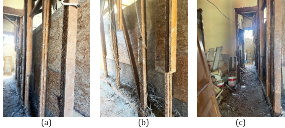
Figura 79 Caso de estudio calle Malfatti N°585, cerro Placeres con daños por (a) y (b) desprendimiento total de abobe; (c) pies derechos atacados por termitas.
