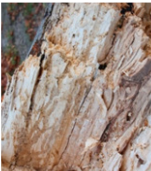
Figura 26 Daños producidos por hongos de pudrición blanda (Maderame, 2020).
