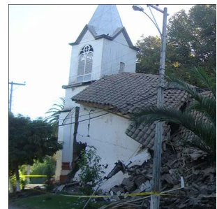
Fig. 2-4 Fotografías de edificios patrimoniales de adobe afectados por el sismo del año 2010 en Chile. ©BBC
