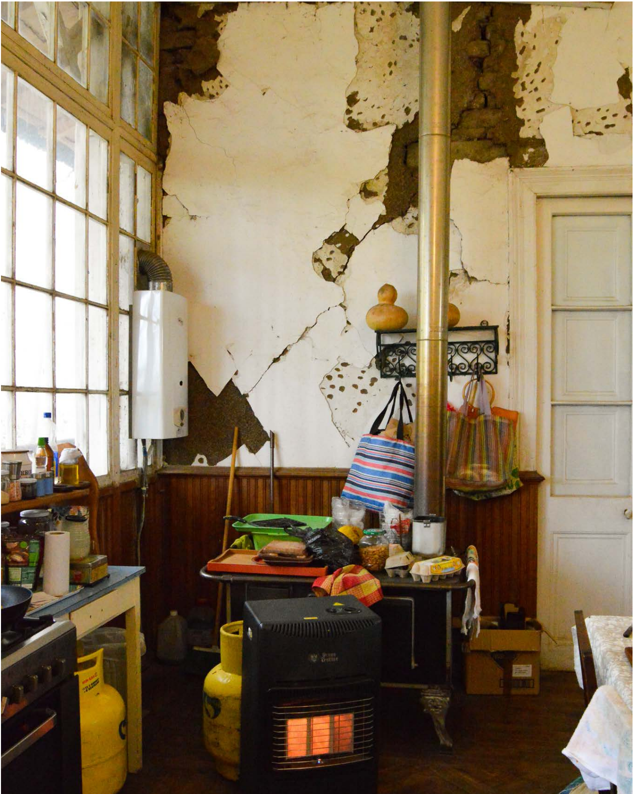
Fig. 7 Vivienda construida en adobe en proceso de rehabilitación. Comuna de Paine, Santiago.
