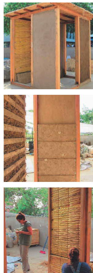
Fig. 12-14 Imágenes investigación de Wieser et al. 2018, acerca de la conductividad térmica de la tierra alivianada con fibras naturales en paneles de quincha.
