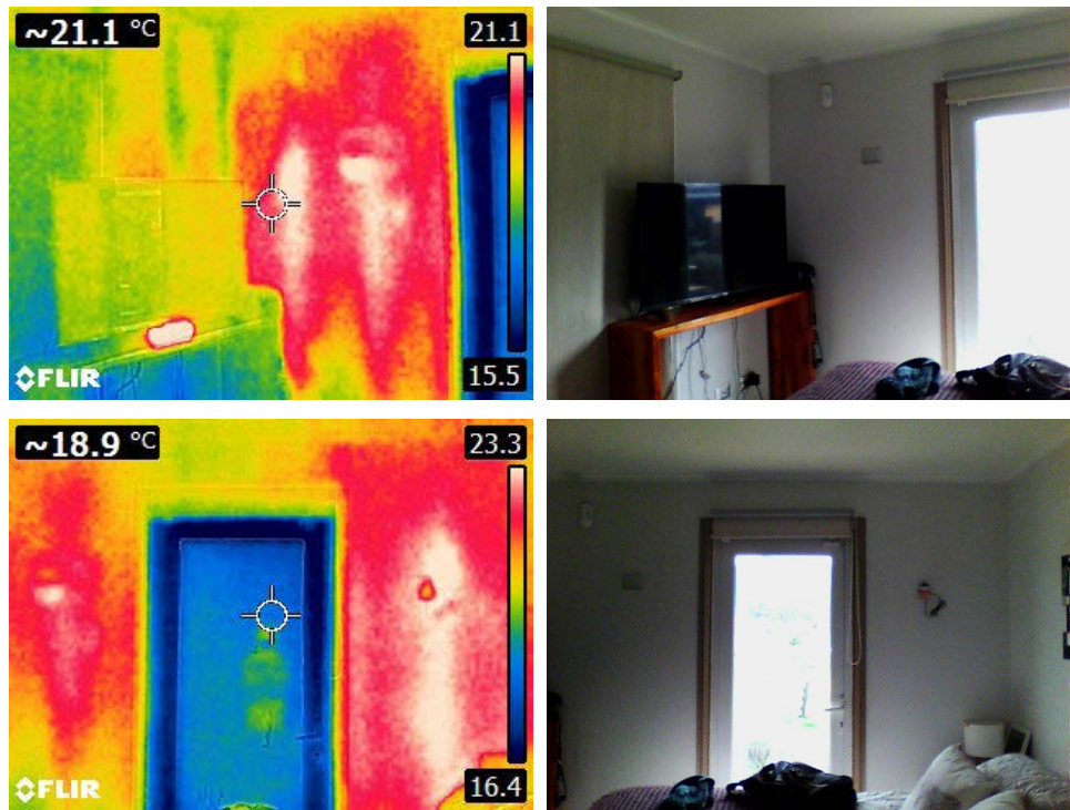
Fig. 77-80 Imágenes termográficas registradas durante el periodo de invierno.
