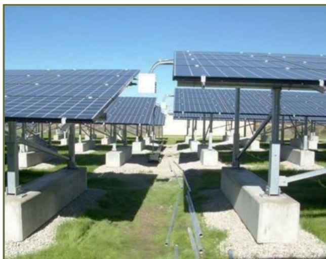
Figura 13: Granja solar de 1,48 MW sobre el relleno Box Canyon, base Marina campo Pendleton, California.
