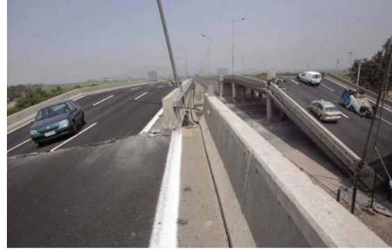
Figura 3. Caída de los vanos del paso superior Miraflores [1]
