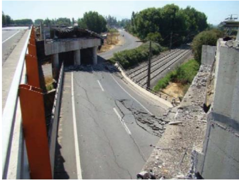
Figura 2. Caída del tablero del puente Hospital [1]
