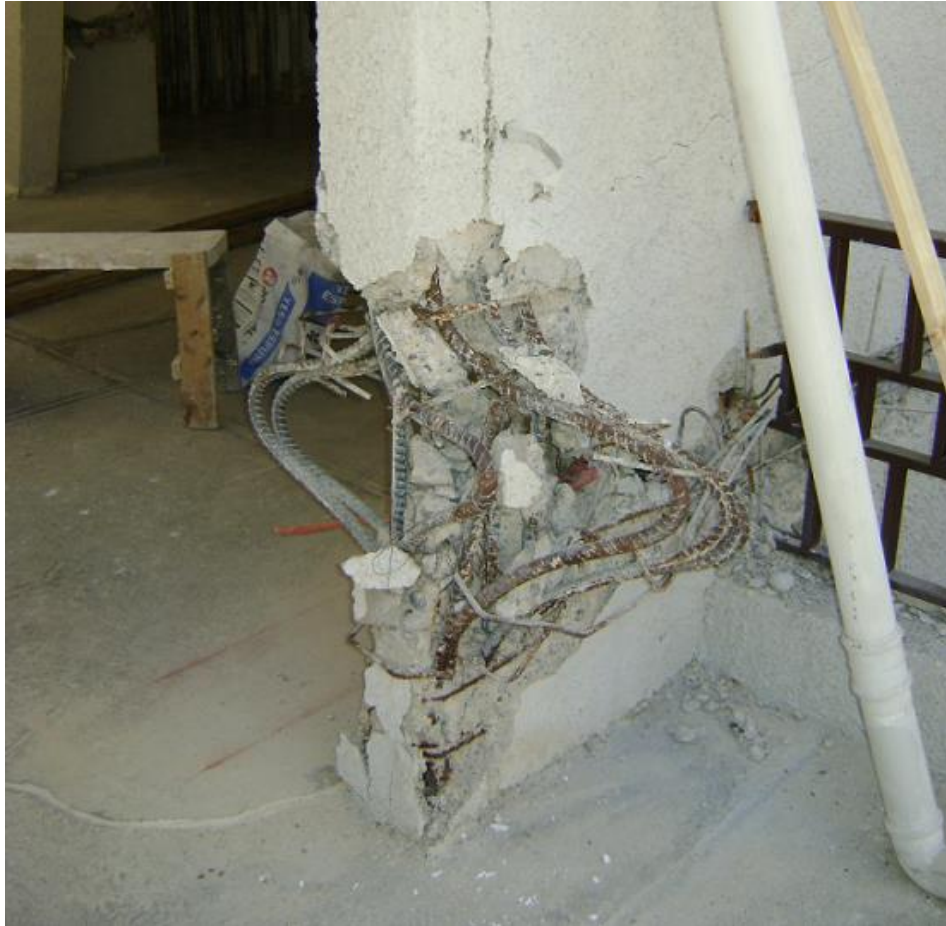
Figura 2.1 Ejemplo de daño estructural
