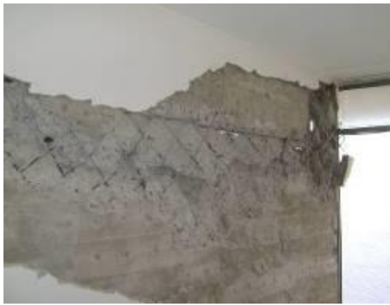
Figura 3.33 Elemento dañado B4-4
