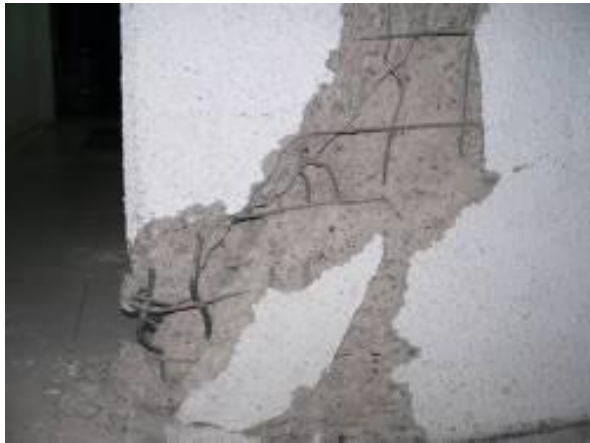
Figura 3.114 Elemento dañado T15-2
