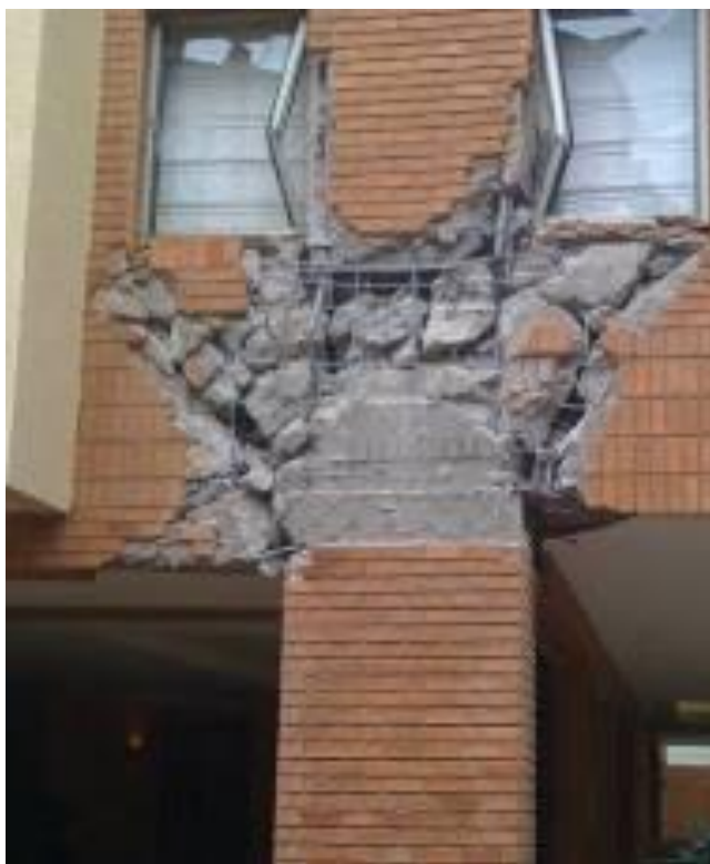
Figura 9.11 Daño en elemento T15-1 (apoyo del elemento 1)
