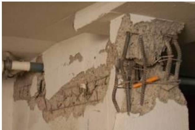
Figura 3.75 Elemento dañado R10-2
