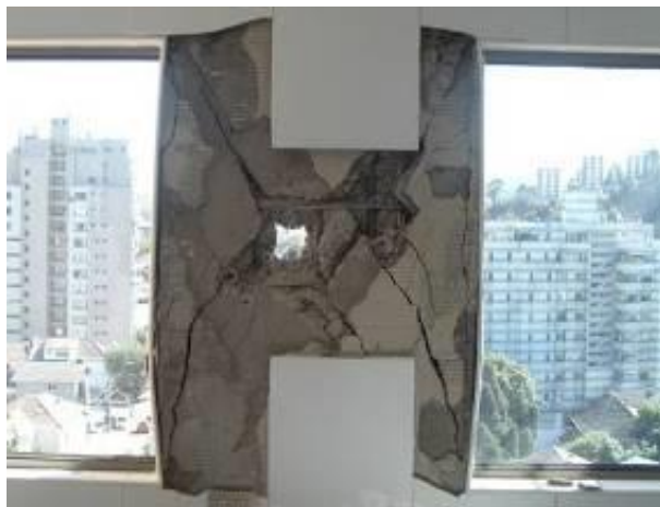
Figura 3.21 Elemento dañado A3-3
