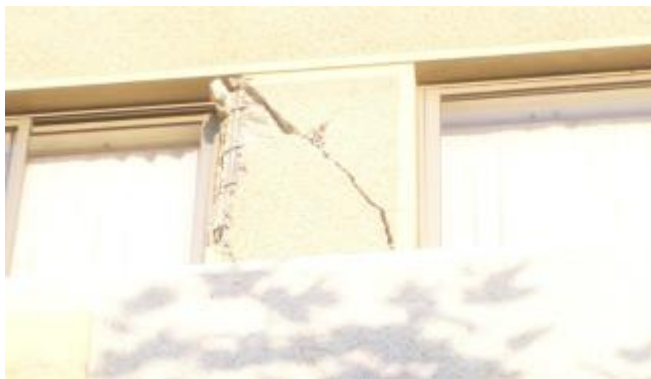
Figura 3.63 Elemento dañado M8-3
