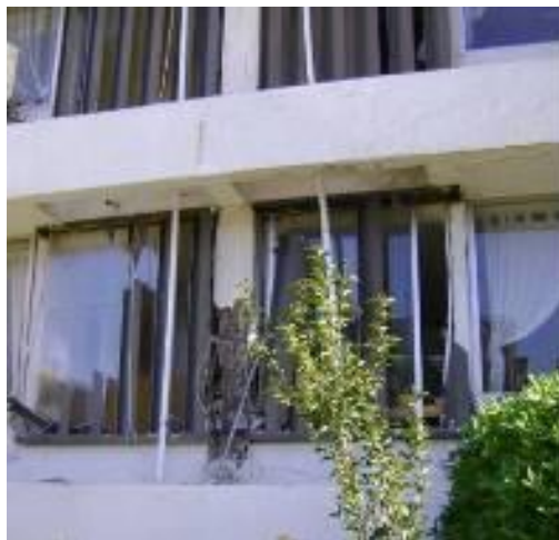
Figura 3.41 Elemento dañado F5-3
