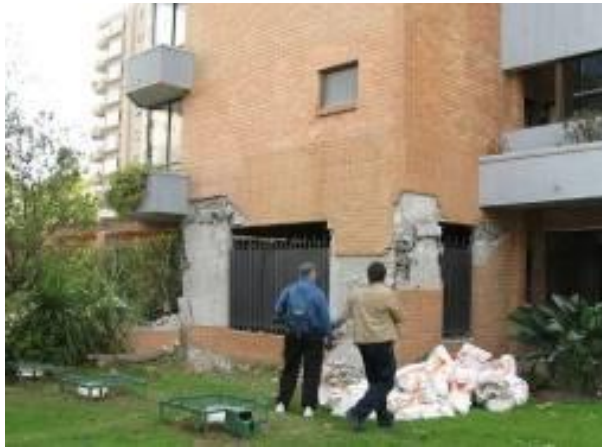
Figura 3.81 Elemento dañado R11-1
