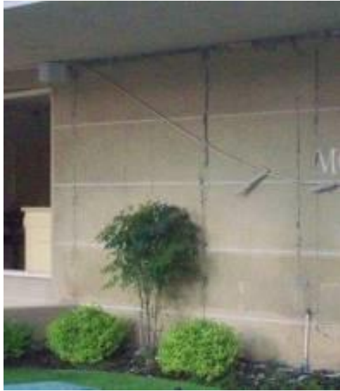
Figura 3.61 Elemento dañado M8-1
