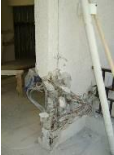
Figura 3.96 Elemento dañado T13-1
