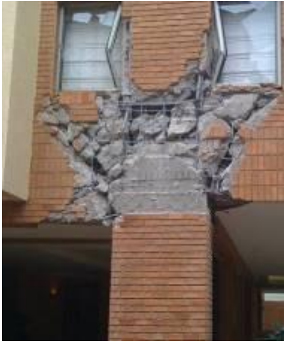
Figura 3.113 Elemento dañado T15-1
