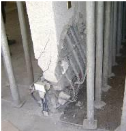
Figura 3.98 Elemento dañado T13-1
