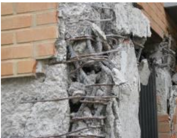
Figura 3.83 Elemento dañado R11-3
