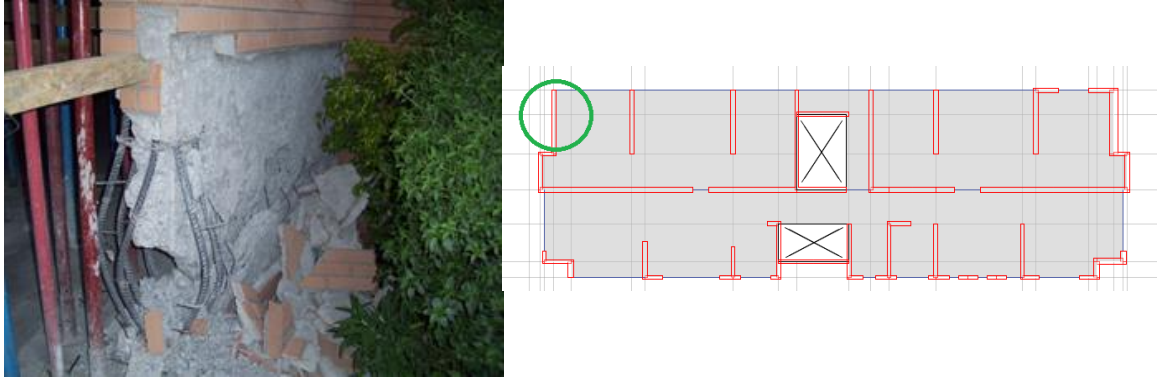
Figura 4.42 Imagen del daño y ubicación en planta del elemento M6-1
