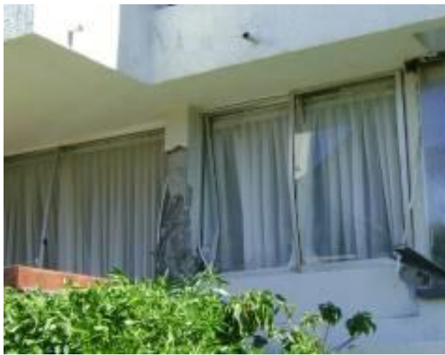
Figura 3.42 Elemento dañado F5-4
