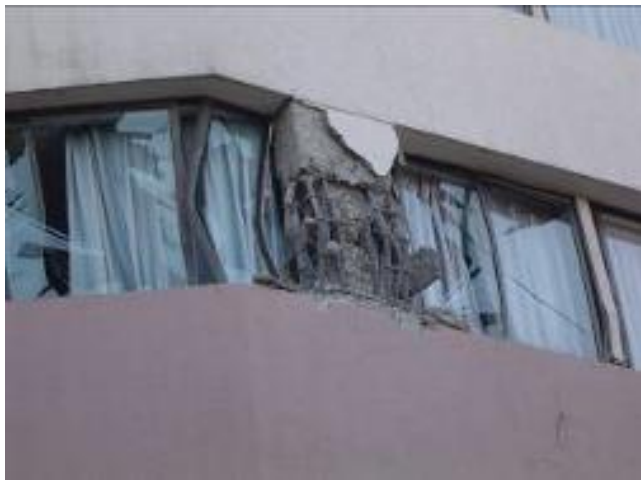
Figura 3.107 Elemento dañado T14-4
