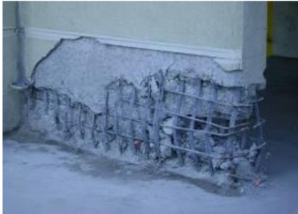
Figura 3.19 Elemento dañado A3-1
