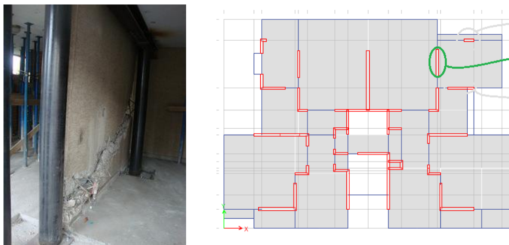
Figura 4.54 Imagen del daño y ubicación en planta del elemento T12-2
