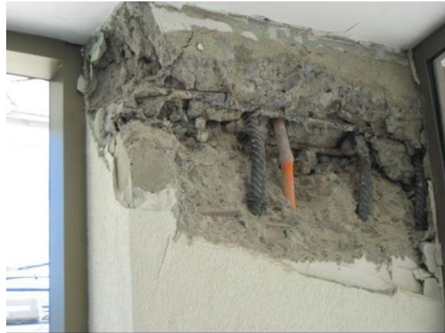
Figura 3.7 Elemento dañado N1-1
