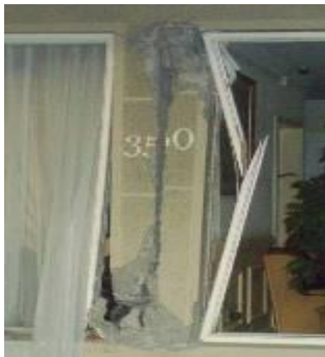
Figura 3.62 Elemento dañado M8-2
