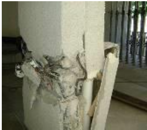
Figura 3.97 Elemento dañado T13-1
