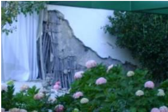
Figura 3.40 Elemento dañado F5-2
