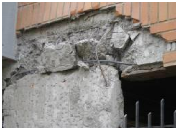
Figura 3.82 Elemento dañado R11-2
