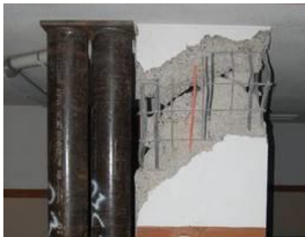
Figura 3.76 Elemento dañado R10-3
