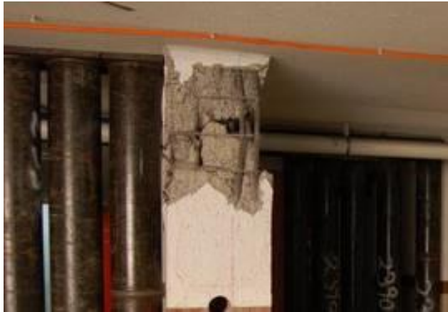
Figura 3.74 Elemento dañado R10-1
