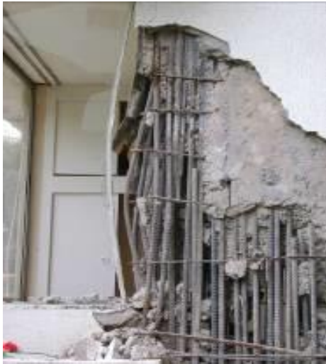
Figura 3.39 Elemento dañado F5-1
