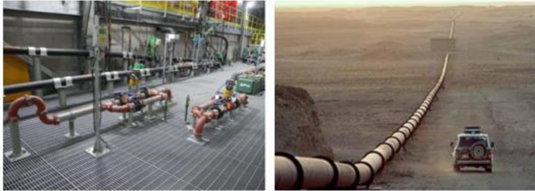
Fig. 3-11: A la izquierda el sistema de bombas, a la derecha la tubería que transporta el relave. Fuente: Zuzunaga (2018).
