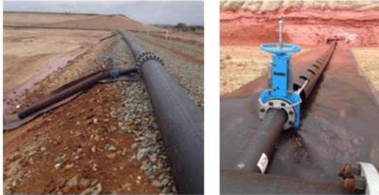
Fig. 3-13: A la izquierda, la tubería de depositación, a la derecha, la salida de tubería desde el grifo. Fuente: Manual de diseño de depósitos de relaves Golder (2015).
