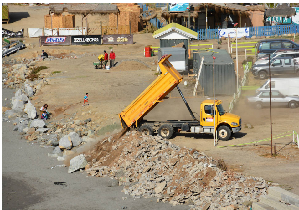
Fig. 56 Relleno de sector la Boca, estacionamientos y estructuras precarias.
