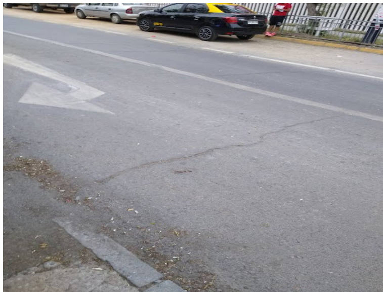
Figura 33. Muestra deterioro tipo grieta transversal. Av. El Pinar, San Joaquín (Fuente: Elaboración Propia).
