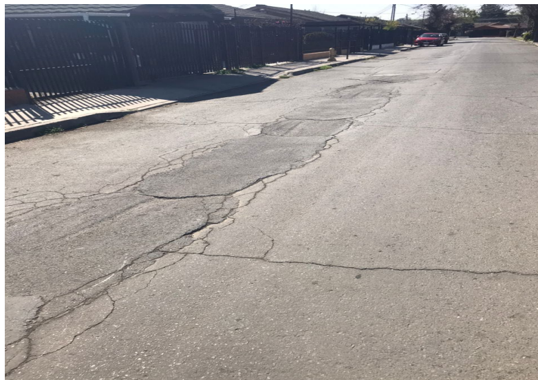
Figura 36: Muestra deterioro tipo Parche Deteriorado. Av. Llancahue, Maipú (Fuente: Elaboración Propia)
