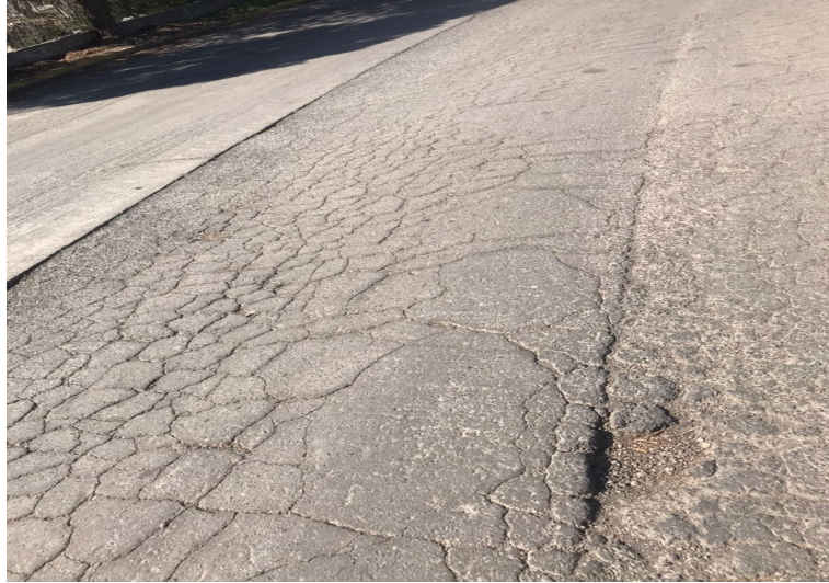
Figura 32. Muestra grieta tipo piel de cocodrilo. Av. Marta Ossa Ruiz, Maipú (Fuente: Elaboración Propia)
