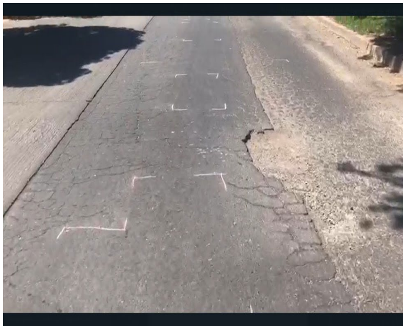
Figura 35. Muestra deterioro tipo bache. Av. Marta Ossa Ruiz, Maipú (Fuente: Elaboración Propia)
