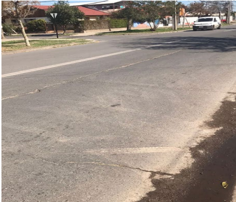
Figura 34. Muestra grietas transversales del tipo reflexión. Av. Las Parcelas, Estación Central (Fuente: Elaboración Propia)
