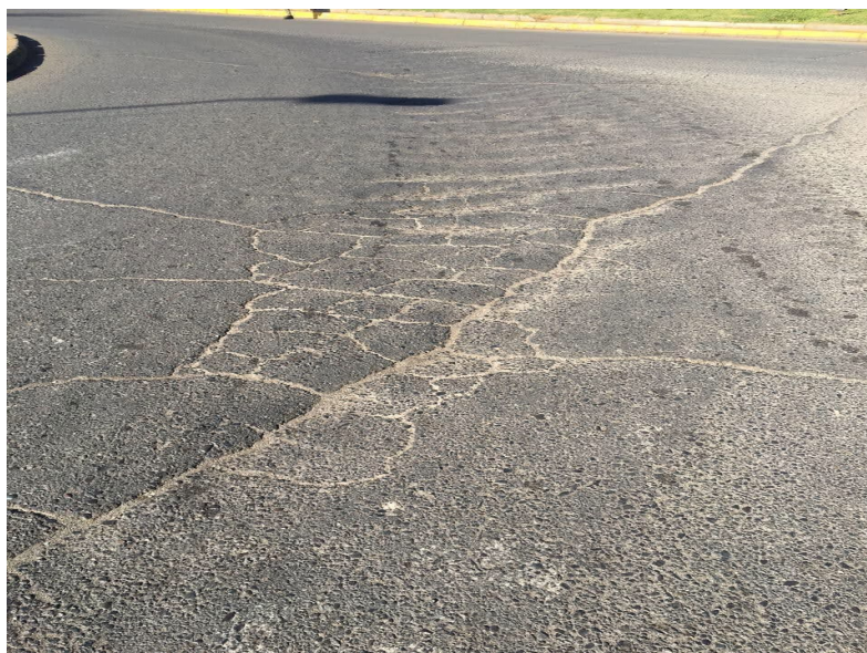
Figura 37. Muestra deterioro de agrietamiento tipo Piel de Cocodrilo con ahuellamiento. Av. El Rosal, Maipú (Fuente: Elaboración Propia)
