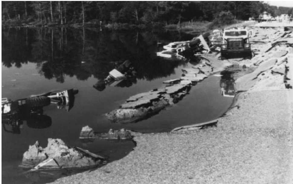
Figura 5-10: Falla por licuefacción inducida del relleno del lago de Ackermann producto de vibraciones geofísicas. Fuente: Hryciw et al. (1990).
