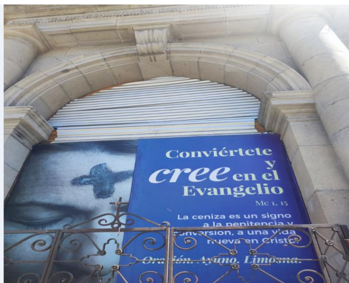
Figura 15 .Fotografía que muestra láminas de acero clavadas en el arco de medio punto del acceso de la Catedral de Santiago, Monumento Nacional, año 2024. Fuente: Elaboración propia.
