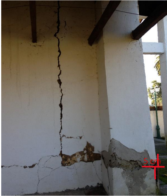
Figura 20. Fotografía donde se observa desplazamiento del muro de la Iglesia, año 2022. Fuente Elaboración propia.
