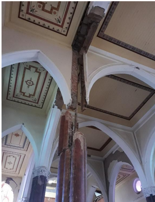
Figura 56. Fotografía del daño en columna, Iglesia de San Francisco, San Fernando. Fuente: Elaboración propia realizada durante el levantamiento crítico
