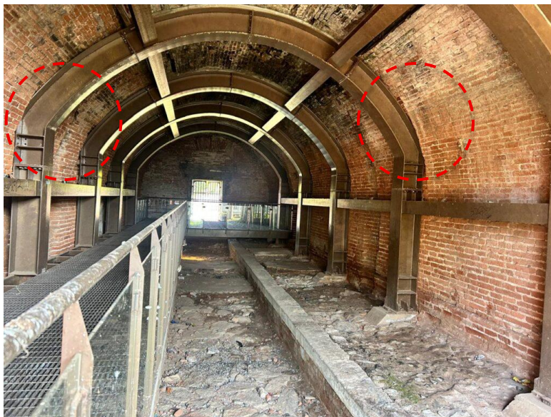
Figura 12. Fotografía que muestra el daño irreversible en la albañilería de la bóveda original para que los arcos de acero pudieran encajar, año 2023. Fuente: elaboración propia
