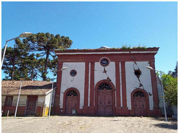
Figura 3. Fotografía de la Iglesia San Leonardo de Porto Mauricio, ubicada en la comuna de Collipulli, año 2021. Se observa daño estructural debido al abandono del inmueble. Fuente: Elaboración propia.
