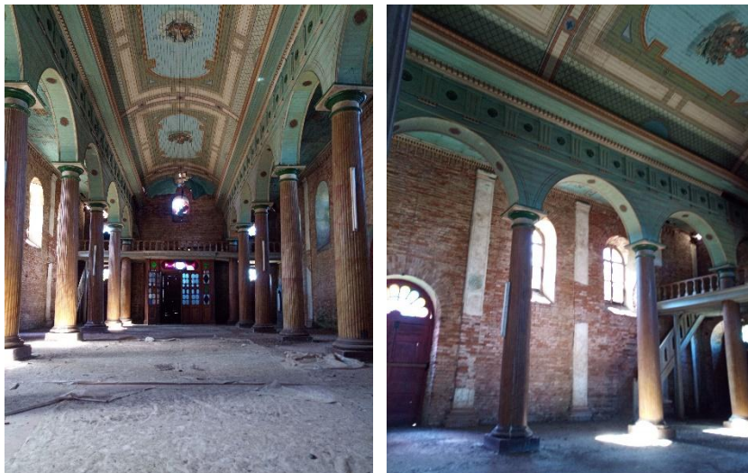
Figura 4. Fotografía interior de la Iglesia de San Leonardo de Porto Mauricio, año 2021. Se observan daños en: estructuras, pavimentos y ornamentación. Fuente: Elaboración propia, tomada y cedida al Consejo de Monumentos Nacionales.
