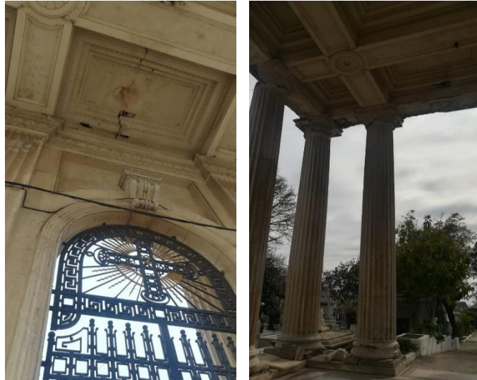
Figura 1. Dos fotografías del acceso al Cementerio N° 1 de Valparaíso, Cerro Cárcel, año 2021. Izquierda: cielo con daño por humedad. Derecha Columnas con daño severo. Fuente: Elaboración propia.
