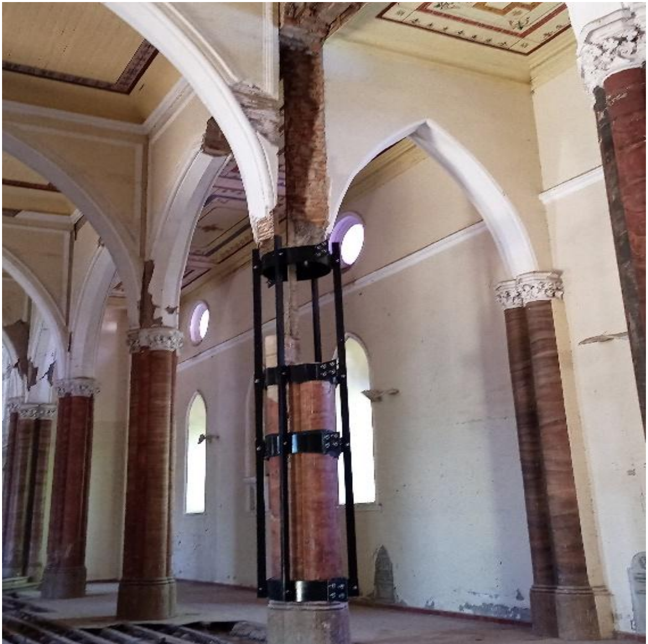
Figura 52. Fotografía estructura ortetica de refuerzo pilar fracturado, año 2022 Fuente propia, fotografía
