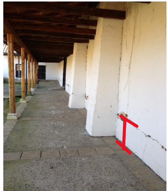
Figura 19 .Fotografía donde se observa una grieta perimetral a nivel de sobrecimiento, año 2022. Fuente Elaboración propia.
