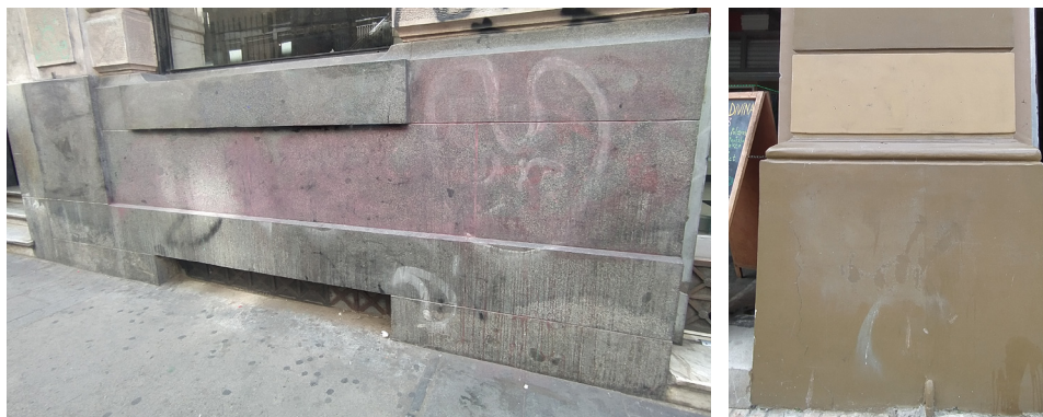
Figura 101. [Izquierda] Ejemplo de ghosting provocado por remoción mecánica, ejecutada de manera incorrecta. Edificio Turri, Calle Prat. Fuente: Archivo personal.
